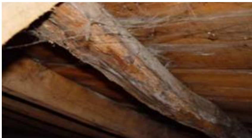
Fig. 2.11 – Viga deformada (Feio et al., 2004).
