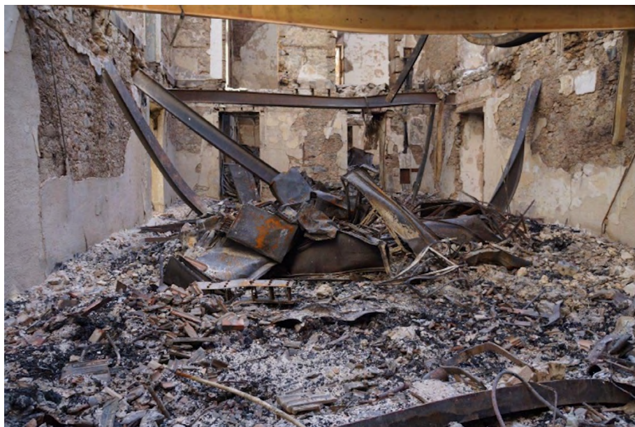
Fig. 1 Vista da sala após o incêndio. Créditos: imagem cortesia do Museu Nacional.
