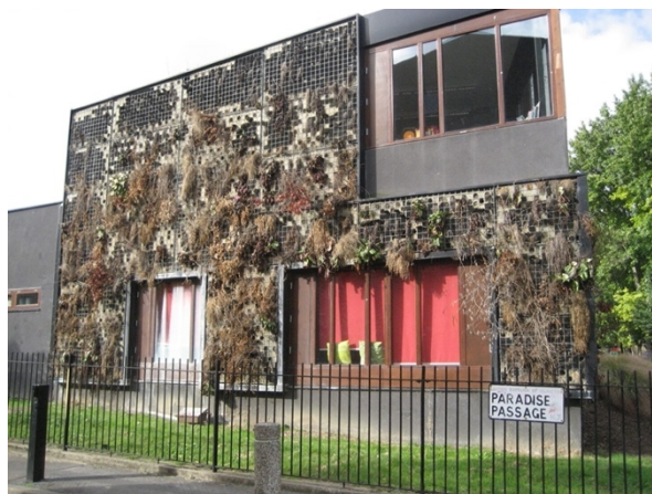
Figura 3.27 – Edifício com parede viva sem qualquer manutenção, levando a vegetação a morrer
