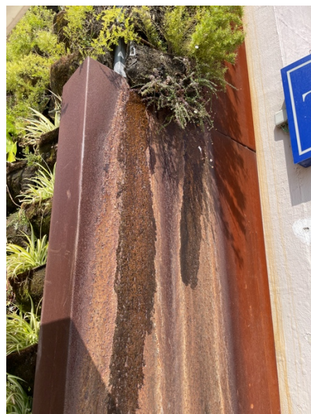
Figura 4.27 – Escorrimento na parede lateral, a este, na parede viva do A Valenciana
