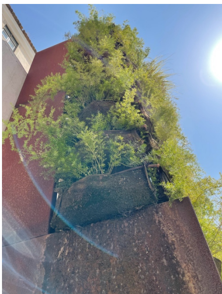
Figura 4.26 – Escorrimento na parede lateral, a oeste, na parede viva do A Valenciana
