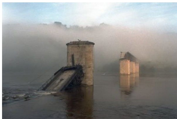
Figura 1.1: Ponte Hintze Ribeiro após o colapso de um dos pilares devido à erosão. Fonte: mediaserver.rr.pt
