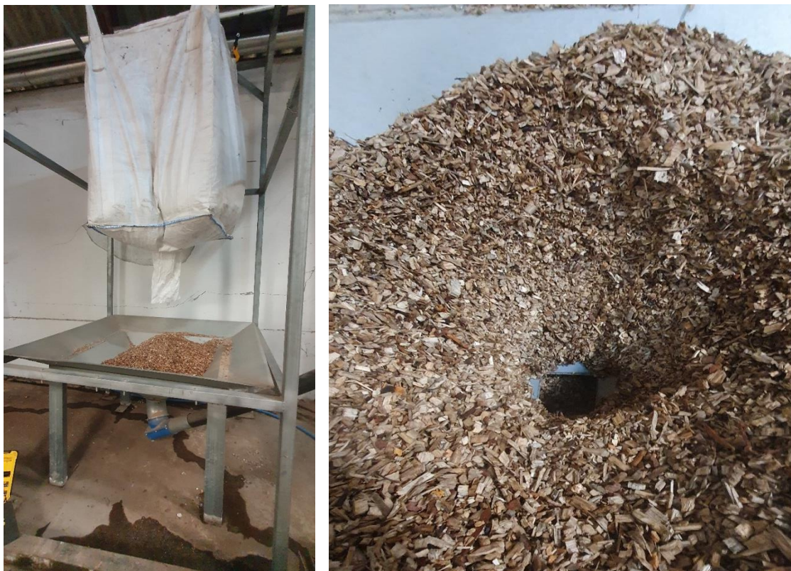
Figura 35 - Silo porta-bigbag (à esquerda) e ponto de extração de combustível (à direita).
