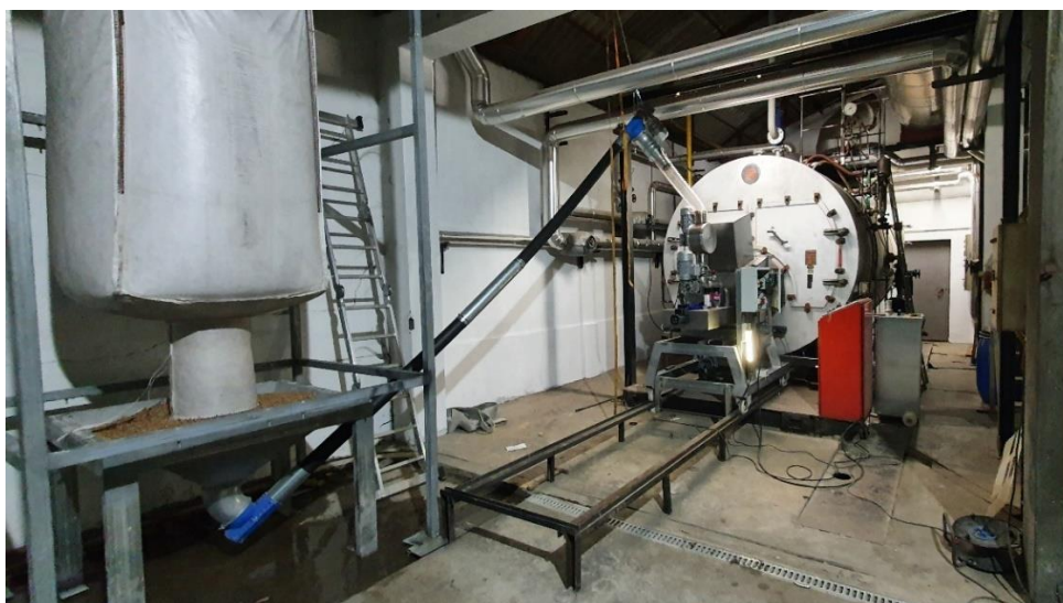
Figura 26 - Caldeira industrial da central térmica da Milega Lda.
