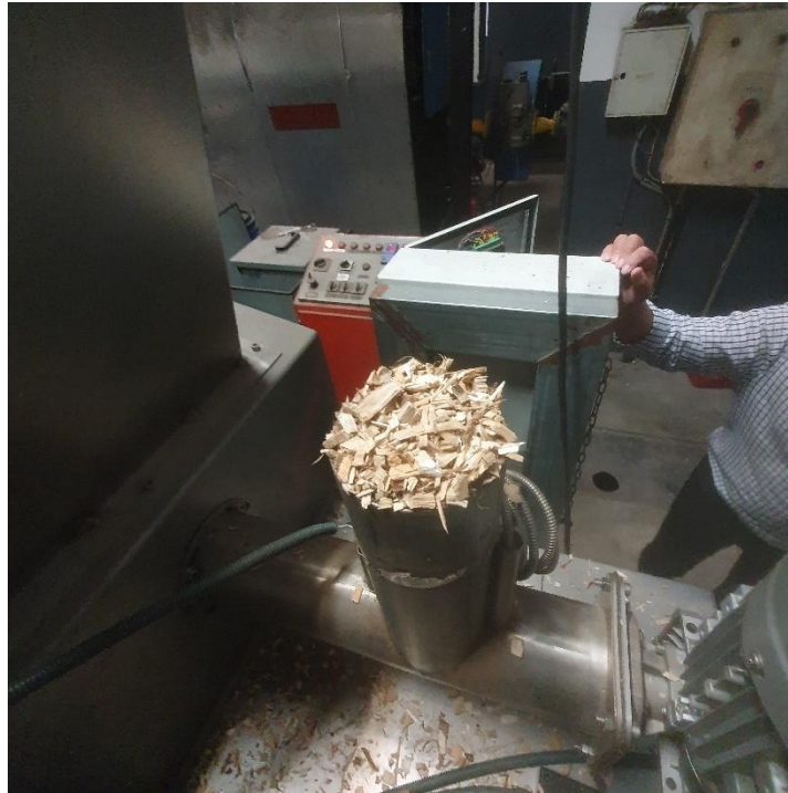
Figura 38 - Encravamento entre a válvula rotativa e o sem-fim horizontal.
