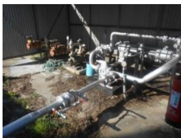
Figura 6.5. Falta de Limpeza (Casa das Bombas)
