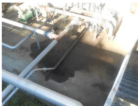
Figura 7.13. Casa das Bombas Gasóleo
