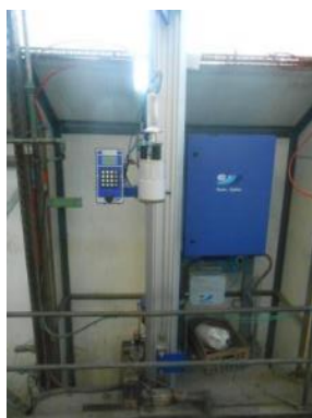
Figura 5.10. Máquina de Deteção de Fuga "KOSAN"
