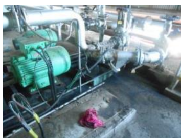
Figura 6.6. Derrame (Casa das Bombas)
