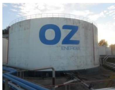
Figura 5.14. Reservatório de Gasóleo TK-15
