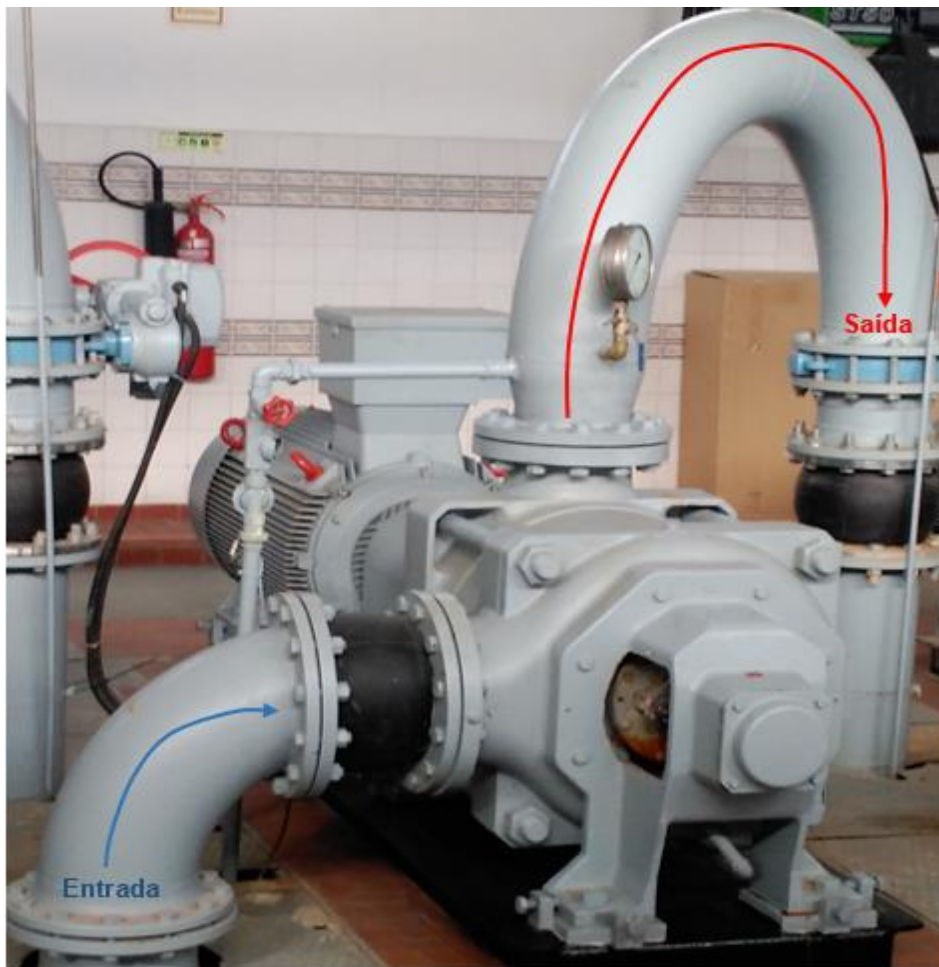
Figura 42 - Fotografia de uma eletrobomba do grupo B, com trajetória da água
