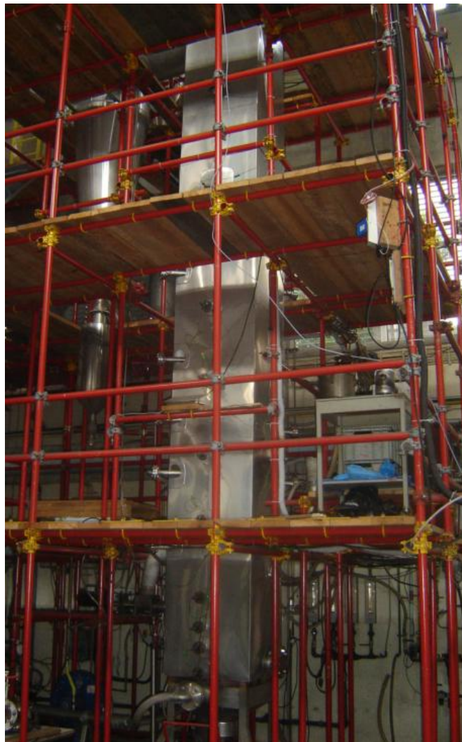
Figura 5.1. Fotografia da instalação de leito fluidizado à escala piloto do LNEG
