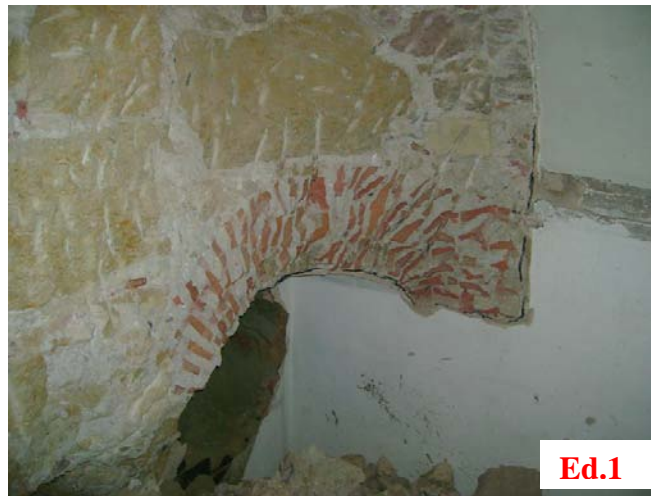
Fig.4.10 – Arco de tijolo e alvenaria de pedra utilizados ao nível da fundação
