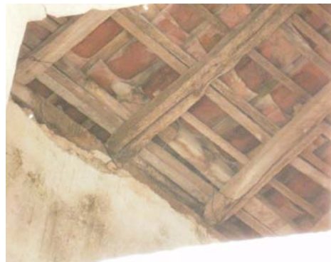
Fig.4.44 – Estrutura da cobertura de um edifício da praça de Manique do Intendente
