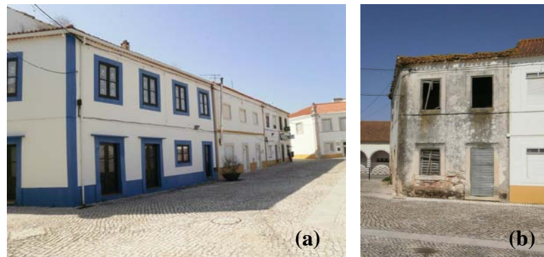
(a) - Continuidade do soco e do beiral ; (b) - Fachada degradada
