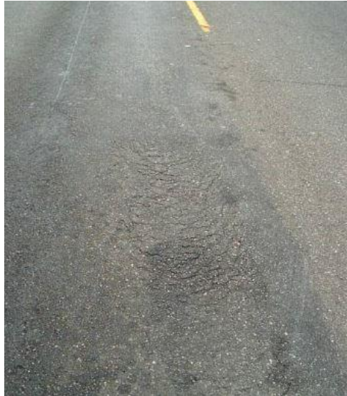
Figura 2.5 - Degradação do pavimento devido a falhas na ligação entre camadas betuminosas, PavInt (2015)
