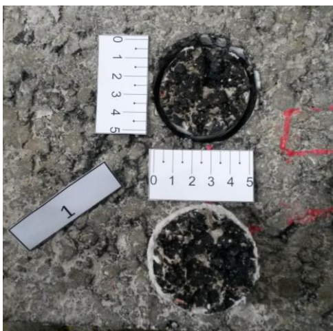
Figura 3.29 - Ruptura pela ligação entre a pastilha metálica de ensaio e a camada de desgaste, provete A1 da obra A
