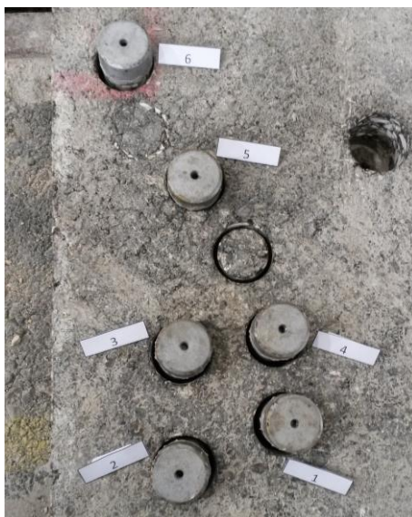
Figura 3.25 - Provetes de ensaio de tração Pull-off da obra A
