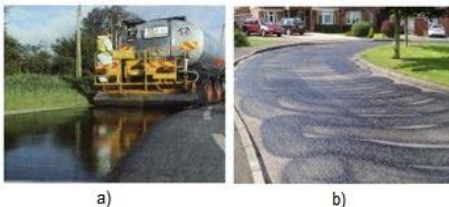
Figura 2.9 - Aplicação de rega de colagem, adaptado de Lancaster (2009) a) aplicação cuidada da rega de colagem, b) aplicação deficiente da rega de colagem
