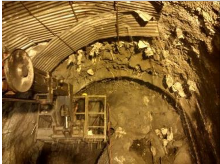
Figura 3.55. Escavação do escombro anteriormente depositado na frente após instalação das HEB e enfilagens.
