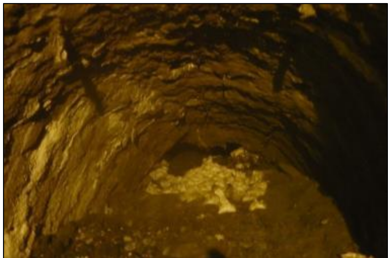
Figura 3.51. Após o avanço de escavação, a afluência de água provocou um colapso parcial da abóbada
