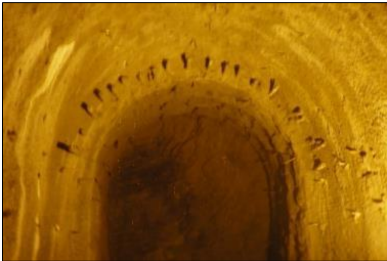
Figura 3.50. Frente de escavação previamente ao colapso
