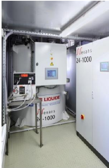
Crióstato no interior do LCS construído
