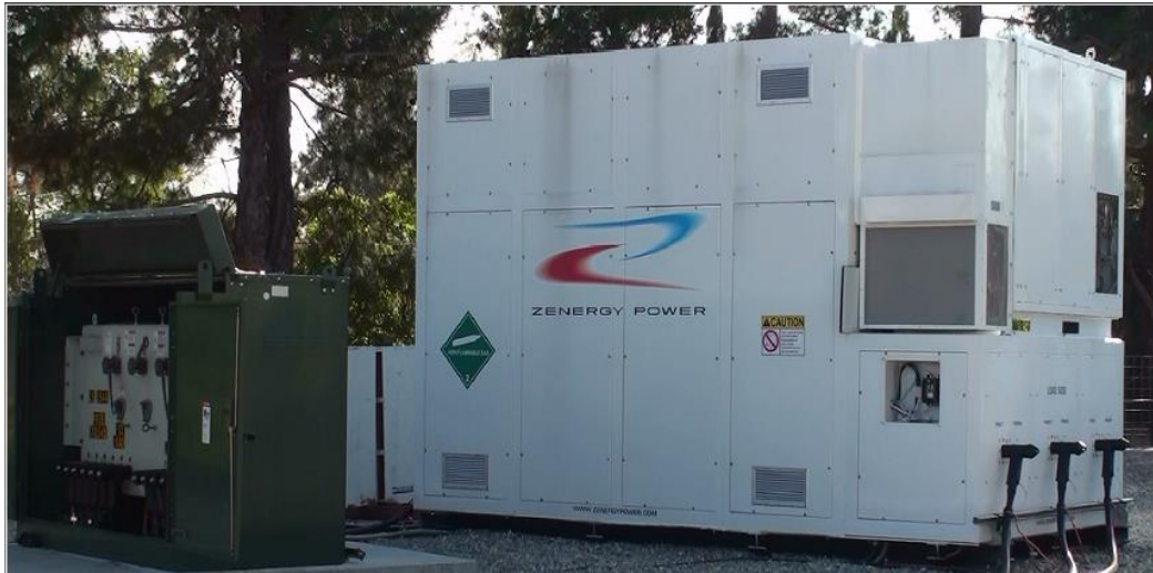
Figura 3.7 - LCS produzido pela Zenergy Power, instalado na subestação "The Circuit of the Future" da rede elétrica dos Estados Unidos da América. Fonte: http://www.zenergypower.com/ . Último acesso em Agosto de 2013.
