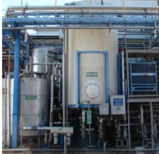
Figura 8.7: Parque de granéis - tanques do sistema CIP.
