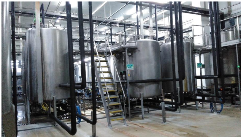
Figura 8.6: Sala de maturadores.
