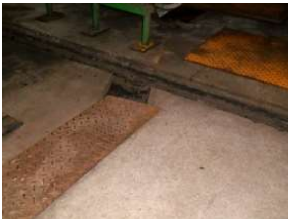
Figura 3.2.- Canalinas na zona de receção de azeitona
