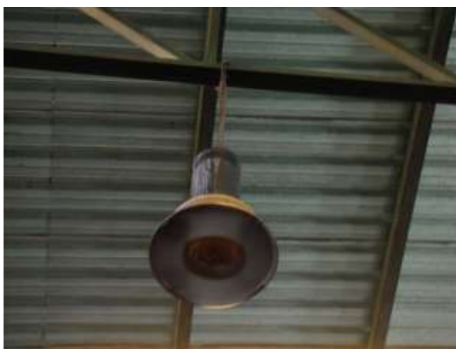
Figura 3.5. – Lâmpada com proteção danificada
