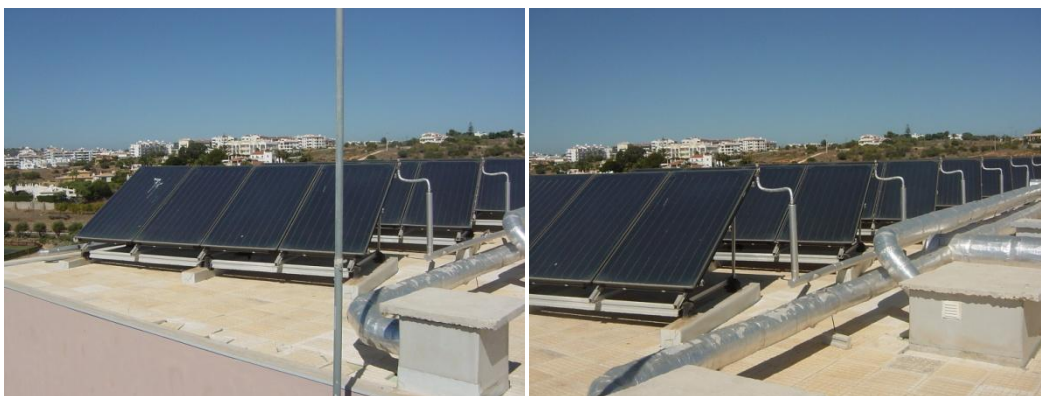
Figura 14- Painéis solares para aquecimento de água
