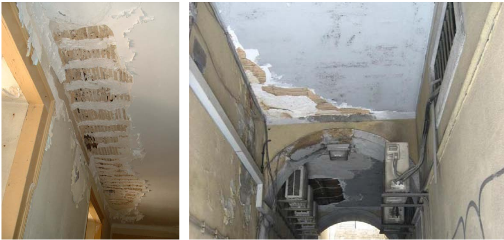
Figura 61 - Estuques aplicados sobre fasquiado de madeira
