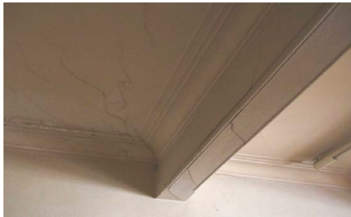
Figura 62 - Fendilhações provocadas pelo desmonte da parede de frontal
