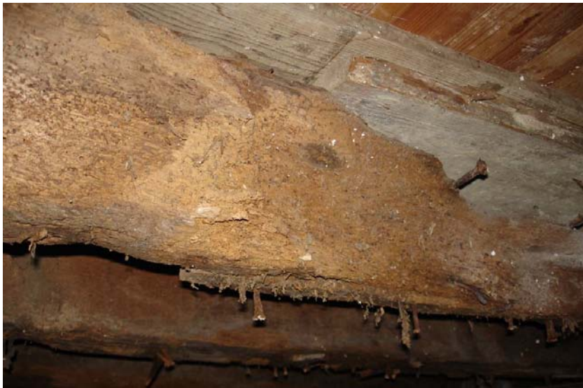
Figura 63 - Degradação da viga de madeira devido a ataque biológico
