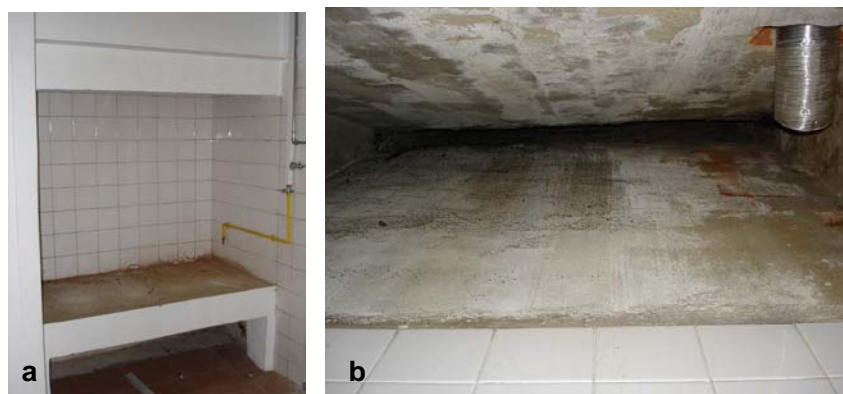
Figura 58 – a) Lareira situada na cozinha na zona adjacente à parede meeira junto ao paramento exterior; b) Chaminé vista pelo interior
