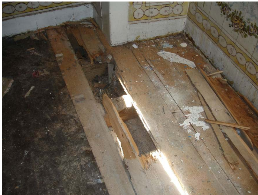
Figura 46 - Caixa de ar entre o soalho e o entulho colocado no extradorso das abóbadas
