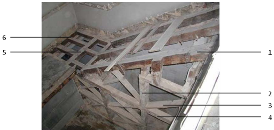
Figura 34 - Estrutura de escadas em madeira: 1) Perna, 2) Prumo, 3) Escora, 4) Travessanho, 5) Cadeia, 6) Tarugo – Adaptado de [33]
