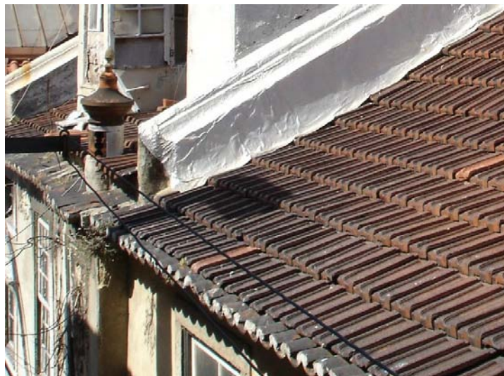
Figura 56 - Prolongamento do tubo de queda para ventilação
