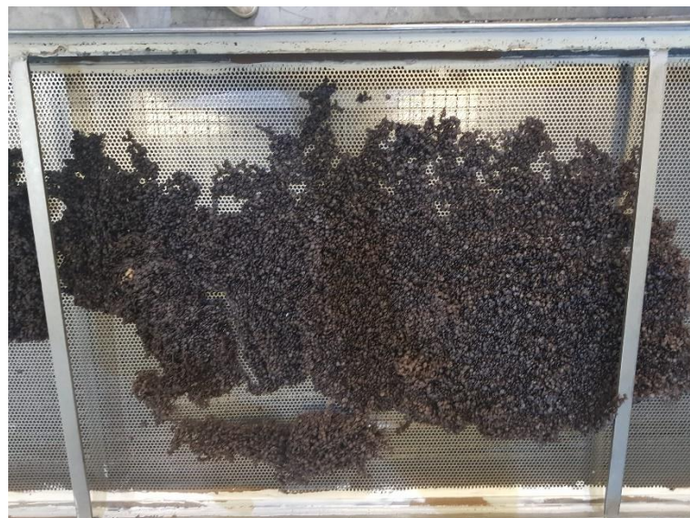
Figura I. 6: Material no interior da passadeira
