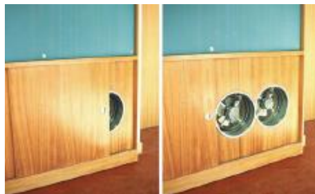
Figura 3.51: Saídas de ventilação no interior das salas (Gonçalves e Cabrito, 2005)
