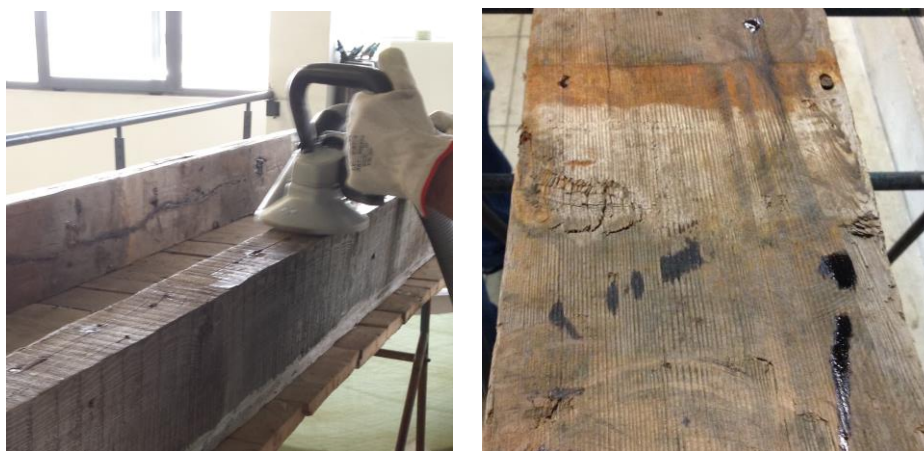
Figura 5.4 – Viga a ser alisada com recurso à lixadeira mecânica e aspeto após alisamento.
