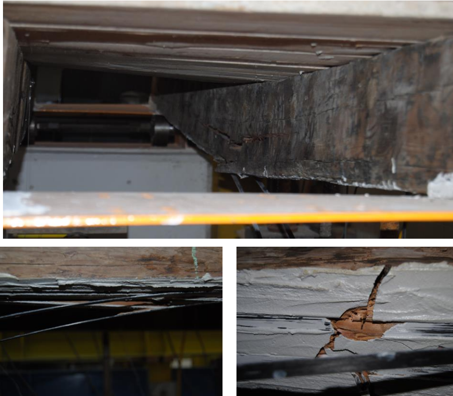
Figura 5.47 – Rotura da viga V4 (PM2).
