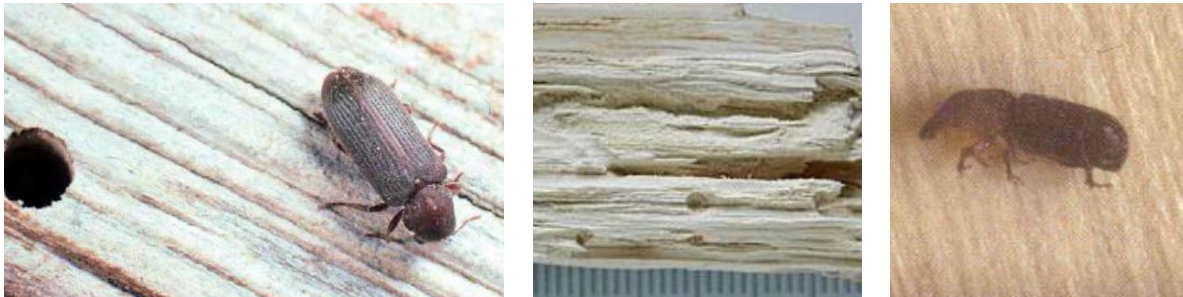
Figura 2.12 – Inseto caruncho, pormenor de ataque de traça e escaravelho da madeira, respetivamente [18].
