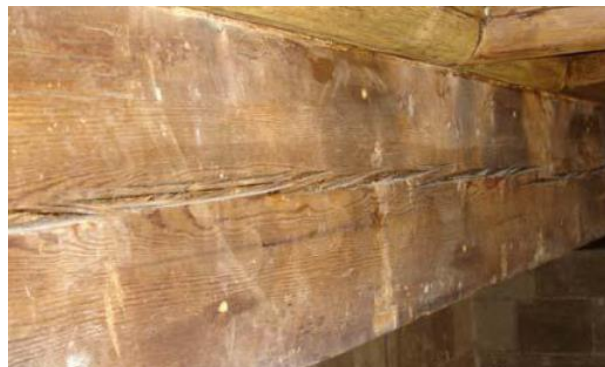
Figura 2.7 – Pormenor de fenda [27].
