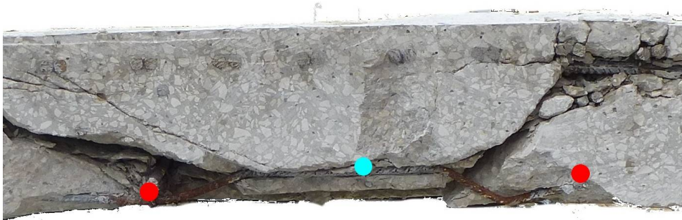
Figura 4.2: Pormenor dos varões mobilizados na rotura pós-colapso (azul) e respetivos ângulos com a horizontal (laje PBC1).
