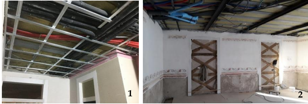
1 - Estrutura de teto falso sob instalações; 2 - Instalação técnica em tetos técnicos
