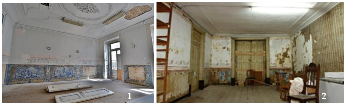
1 - Revestimento de paredes com azulejos 2 - Tabiques deteriorados e azulejos em falta em falta e tetos degradados
