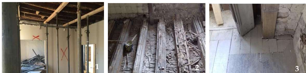
1 - Escoramentos em tetos; 2 - Pavimento existente degradadas; 3 - Estrutura de pavimentos existentes
