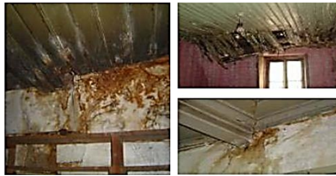
Fig. 2.6 - Apodrecimento e fragilização (infiltrações) (extraído de Vicent, et al., 2008)
