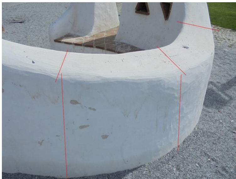
Figura 5.9 – Faixa húmida junto do embasamento e com realce de fendilhação
