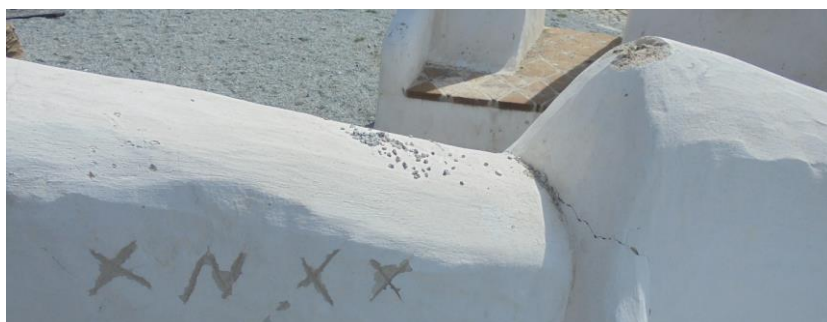
Figura 5.8 – Destaque, Fissuração e Vandalização
