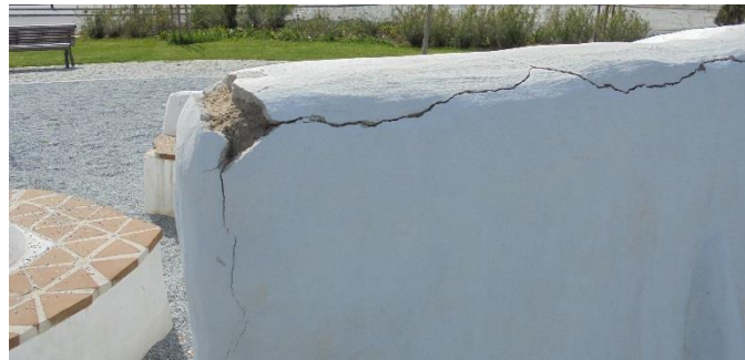
Figura 5.5 – Destaque e fissuração de reboco
