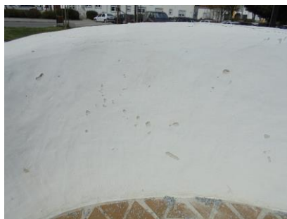
Figura 5.6 – Situação originada por vandalização
