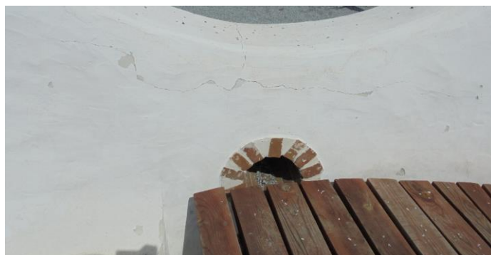
Figura 5.7 Fendilhação do reboco
