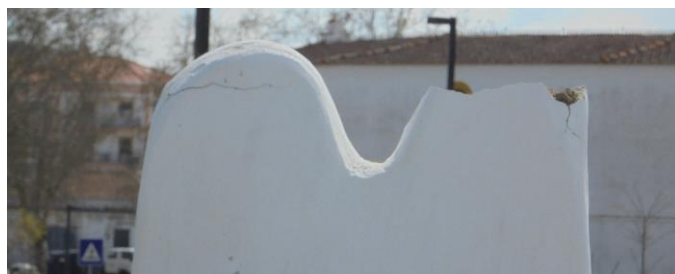
Figura 5.10 – Destaque total do reboco
