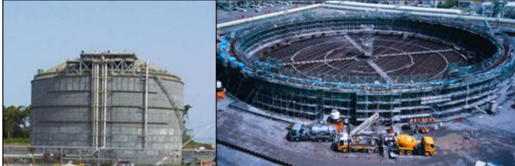
FIGURA 2 – UTILIZAÇÃO DO BAC NA CONSTRUÇÃO DOS TANQUES DE GÁS DA OSAKA GAS CO.
