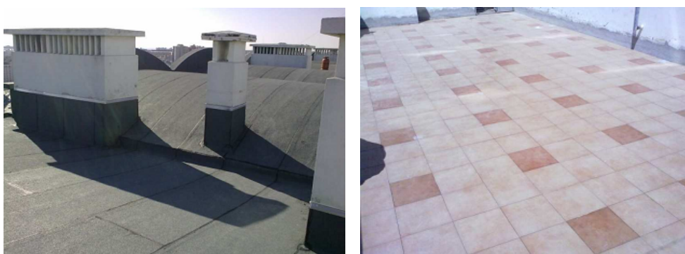
(a) Aplicação de rufo metálico num remate com elemento emergente. (b) Introdução do remate na parede de alvenaria elemento emergente.
