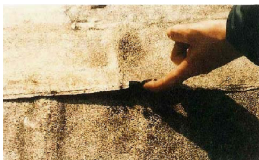
Fig. 3.7: Descolamento da junta de sobreposição num revestimento de impermeabilização [HARRISON, 1996].
