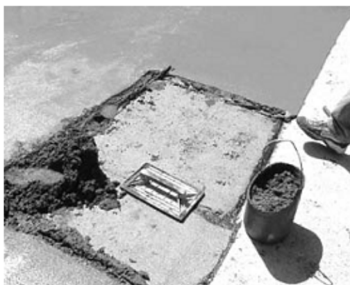
Fig. 3.1: Inexistência de camada de dessolidarização entre a betonilha e o revestimento de impermeabilização [SILVA e GONÇALVES, 2001].
