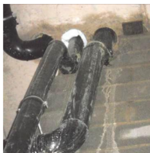
Fig. 3.17: Infiltrações de água junto a embocaduras dos tubos de queda [ANTÓNIO, 2011].
