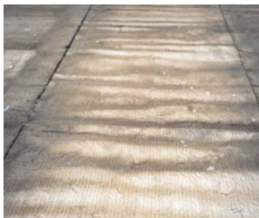
Fig. 3.6: Formação de pregas no revestimento de impermeabilização [WALTER, 2002].
