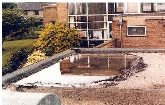
Fig. 3.5: Acumulação de água na cobertura devido à deficiente conformação da camada de forma [HARRISON, 1996].
