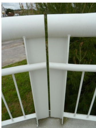
Figura 4.38 - Descontinuidade nas guardas do tabuleiro, na zona dos pilares.
