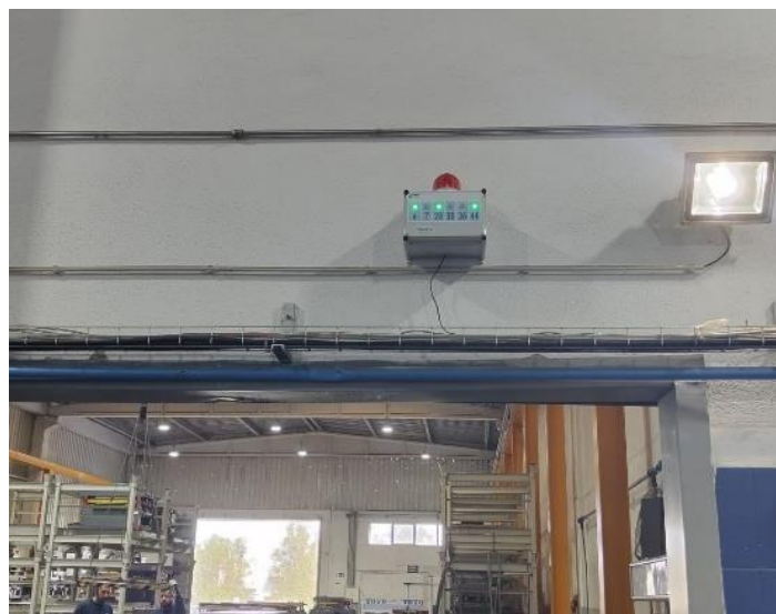
Figura 19 - Painel em funcionamento
