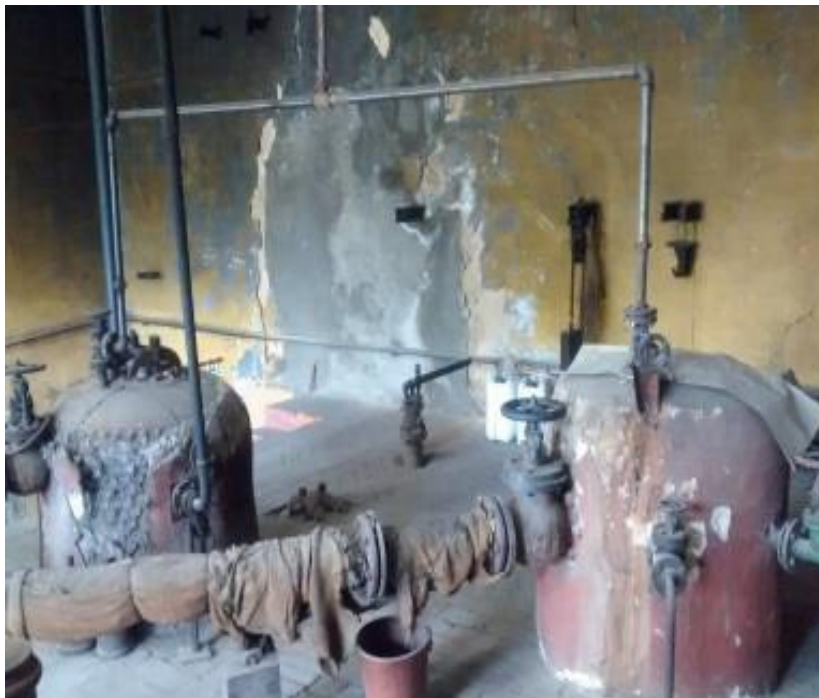
Figura 16 - Fotografia das cúpulas da parte superior das caldeiras
