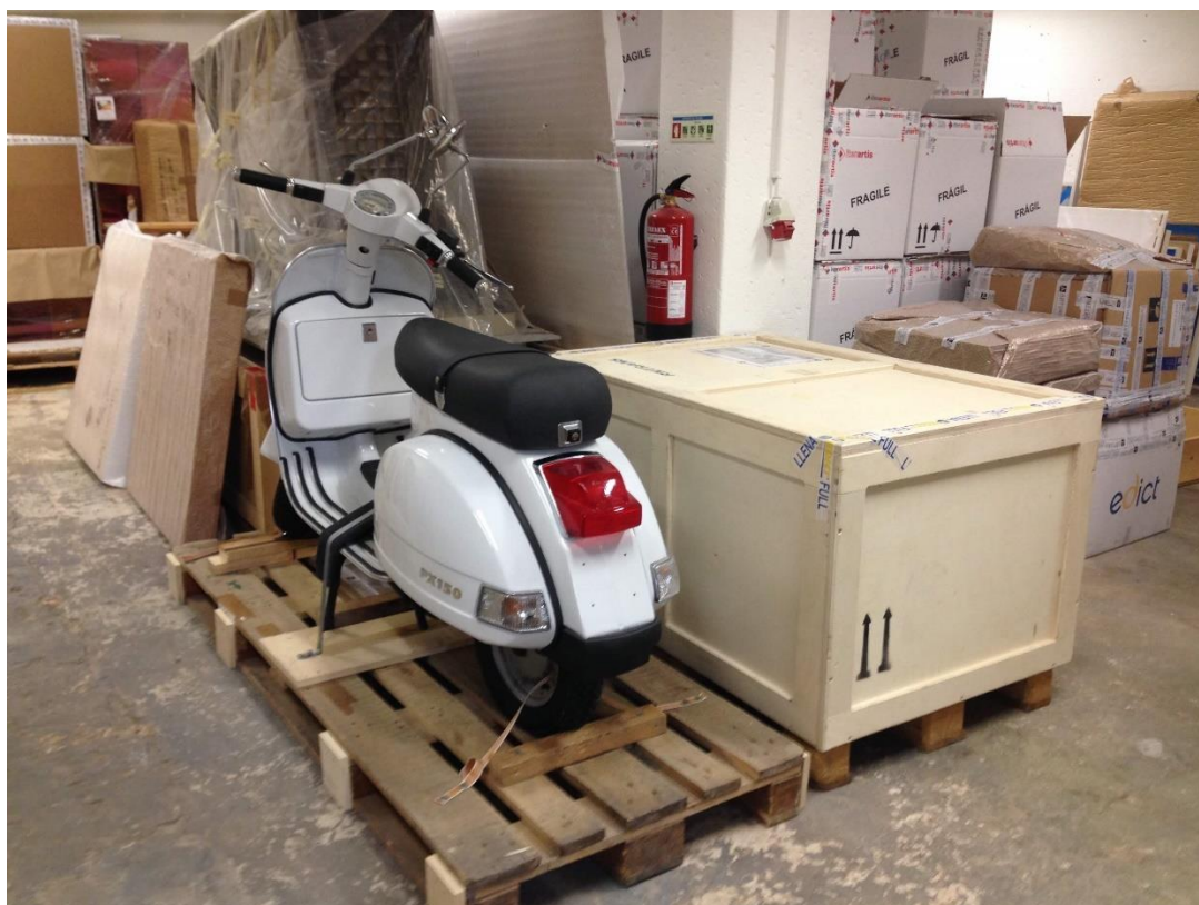
Figura 4.7 - Extintor Obstruído Piso -1
