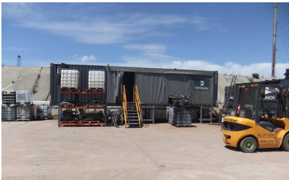
Figura 3.4 – Unidade de centrifugação trifásica - Refinaria de Sines.
