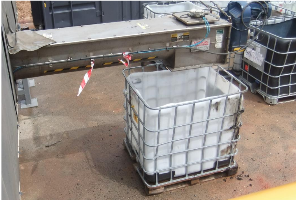
Figura 3.8 - Zona de saída das lamas desidratadas.
