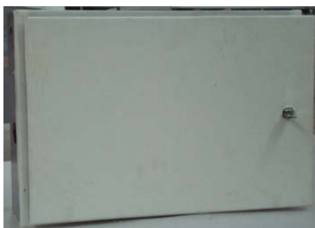
Fig.25 - Caixa de transformação eléctrica, exterior.
