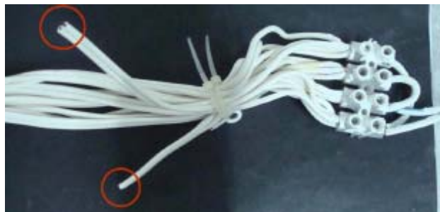
Fig.15 - Cabos eléctricos cortados.
