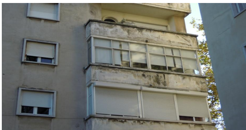
Figura 1.2 - Anomalia em fachada, desenvolvimento de fungos
