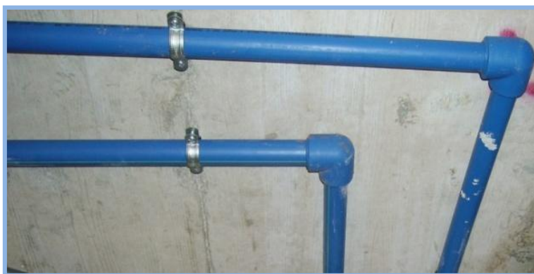
Figura 8 - Falta de isolamento nas tubagens de água quente (tubo de polipropileno).
