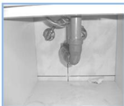
Figura 10 - Inexistência de sifão na instalação (nem individual nem colectivo) [79].
