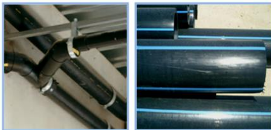
Figura 36 - À esquerda tubos de PEAD instalados em calha suspensa, à direita tubos de PEAD em vara [51].
