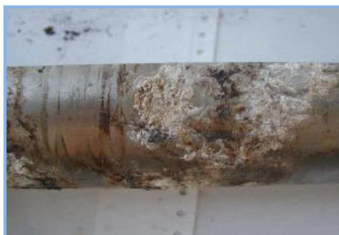
Figura 17 - Corrosão exterior em tubos de aço inox [86].
