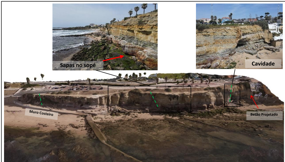
Figura 11 – Imagem frontal da arriba da Bafureira, destacando: os três filões verticais (linha pontilhada em verde); o muro costeiro a poente: a formação de sapas no sopé da arriba; a cavidade na base da arriba e a intervenção com betão projetado nos limites da arriba com o restaurante existente, a nascente.
