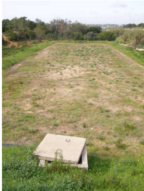
Figura 4.16 – Leito filtrante da bacia designada BTA ao km 40+220 da A22, lanço Alcantarilha-Guia (fonte: LNEC, 2008)
