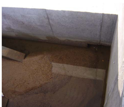
Figura 4.7 – Aspecto do assoreamento parcial do desgordurador (fonte: ALBUQUERQUE et al. , 2006)
