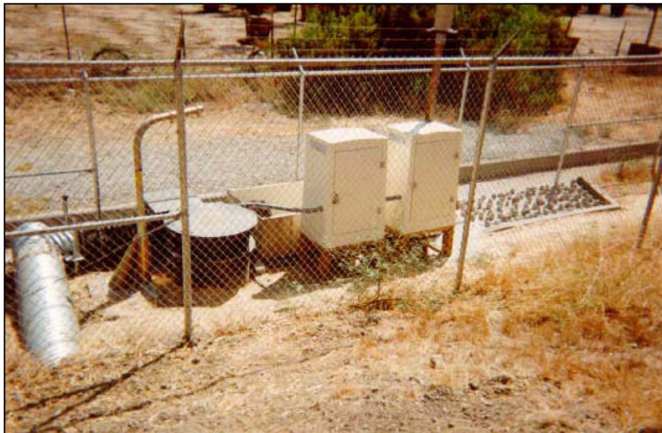
Figura A2.17 – Vista da instalação de um CDS (fonte: CALTRANS, 2004)
