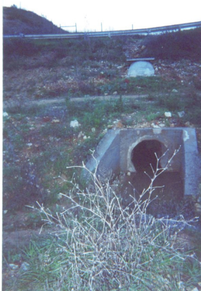
Figura 4.15 – Descarga para o meio receptor da A22, lanço Guia-Alcantarilha (fonte: TEIXEIRA D'AZEVEDO, 2001)
