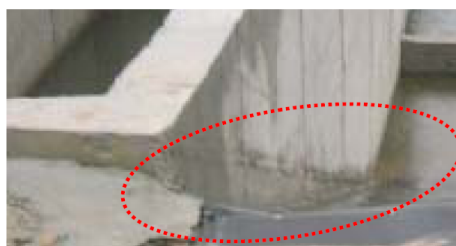
Figura 4.6 – Ponto de descolagem da tela impermeabilizadora, junto a uma das saídas do desgordurador (fonte: ALBUQUERQUE et al. , 2006)
