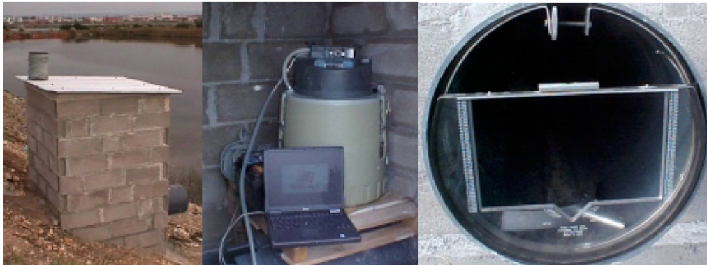
Figura 2.3 - Estação de monitorização instalada no estudo de monitorização das AEE no IP5 – junto ao nó da Gafanha da Nazaré: cabine com udómetro na cobertura; amostrador automático com computador portátil ligado para recolha de dados; descarregador de água para medição do caudal (fonte: ANTUNES e BARBOSA, 2005)
