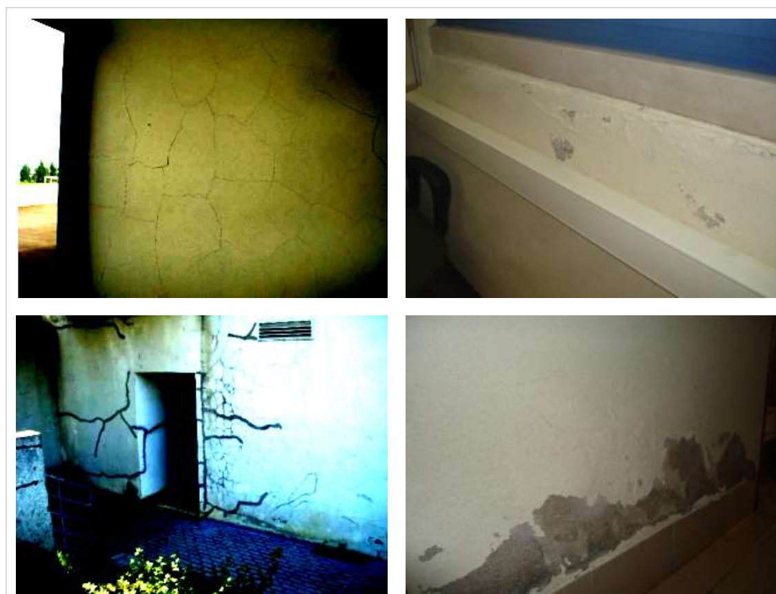
Figura 5.5: Deficiências identificadas no edifício Departamental (UNL-FCT et al., 2015).
