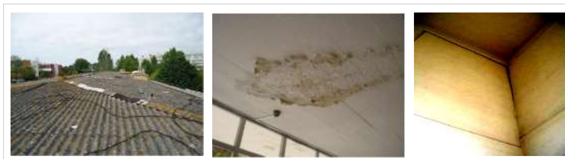
Figura 5.3. Deficiências identificadas no edifício I (UNL-FCT, Sgcie, & Moe, 2015).
