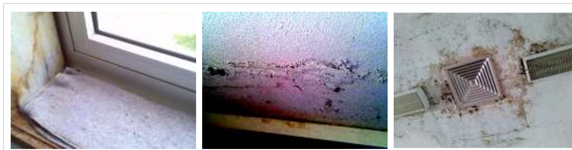
Figura 5.4. Deficiências identificadas no edifício II (UNL-FCT et al., 2015).
