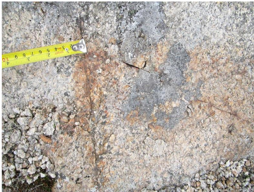
Figura 5.19 - Pormenor onde é visível a ocorrência de óxidos de Ferro numa descontinuidade C3 – P3.
