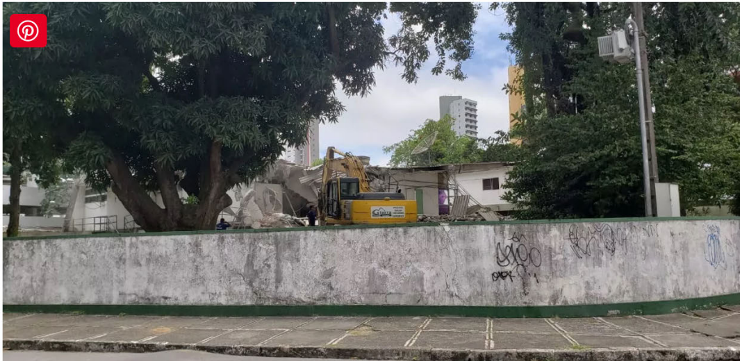
Máquinas trabalham na limpeza do terreno onde antes ficava a casa modernista (Foto: Reprodução/Docomomo Brasil)
