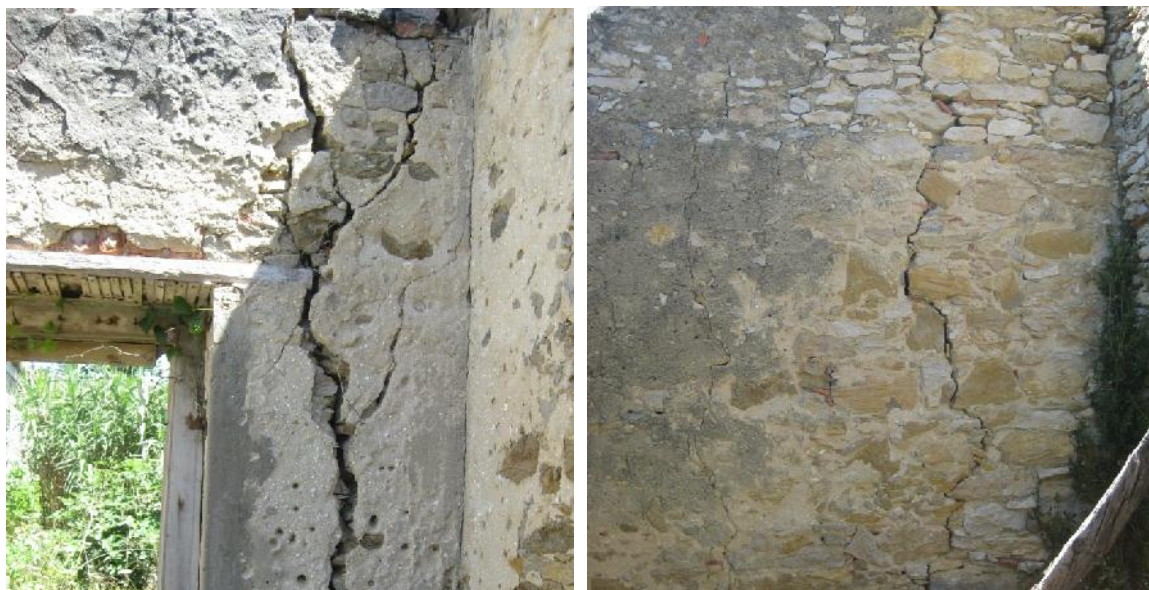
Fig. 2.7 – Fendilhação em paredes de alvenaria de pedra
