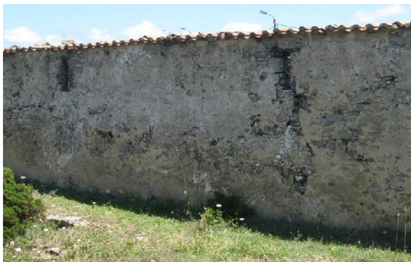
Fig. 2.8 – Desagregação de alvenaria
