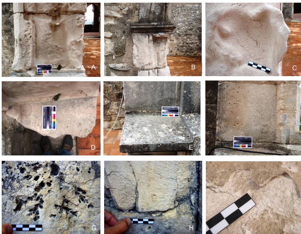
Figura 6.14 – Imagens das principais formas de degradação existentes: desagregação granular e esfoliação (A,B,C e D), colonização biológica e biofilmes (B e E), alveolização (F), perfurações (G), fissuras (H) e crostas (I).
