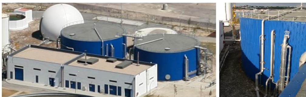
Figura 3.6 – Digestores anaeróbios da ETAR do Seixal (SIMARSUL, 2014).
