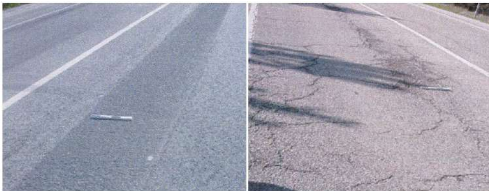
Figura 2.7- Desagregações superficiais com altura entre 30 cm e 100 cm (Nível 2) (E.P., 2008)
