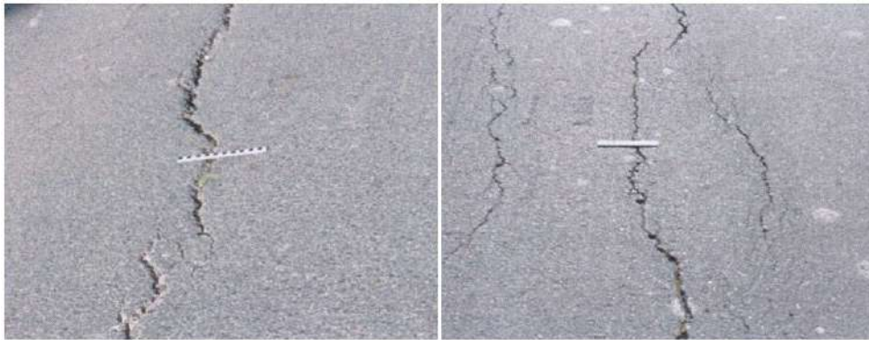
Figura 2.2- Fendas longitudinais ramificadas com perda de material e acompanhada de deformações (nível 3) (E.P., 2008)
