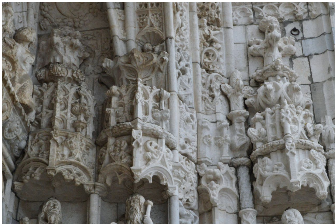
Fig. 135 — Portal Sul (baldaquinos interiores direitos), Mosteiro de Santa Maria de Belém, Lisboa
