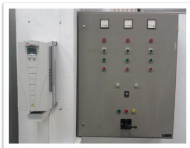
Figura 4.16 – Quadro de comando electrónico e quadro eléctrico
