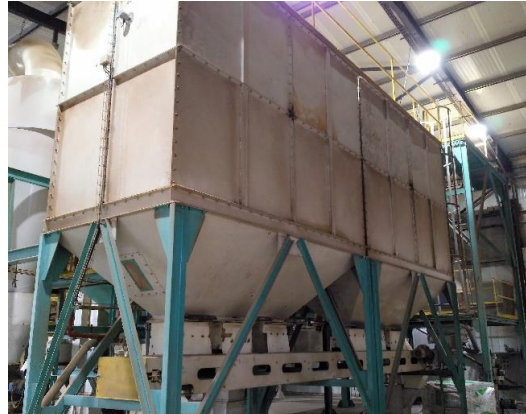
Figura 5.10 - Silo de pellets
