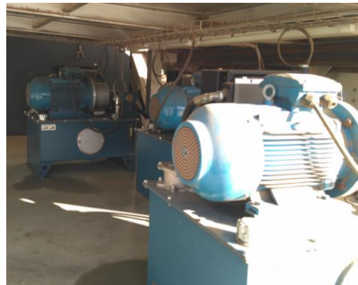
Figura 5.33 – Centrais energéticas hidráulicas
