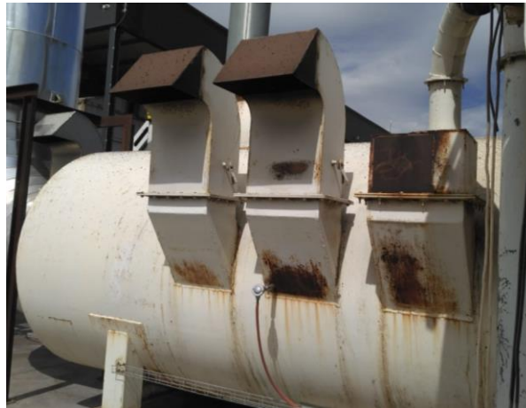
Figura 5.58 - Condutas de entrada de ar
