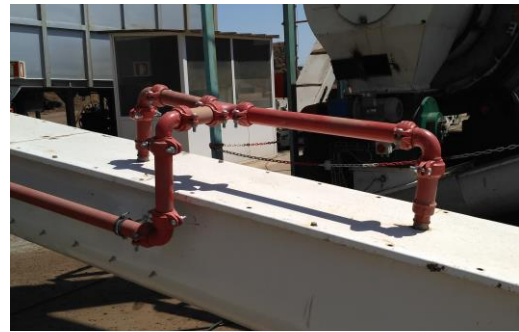
Figura 5.14 – Tubagem de água ligada aos aspersores
