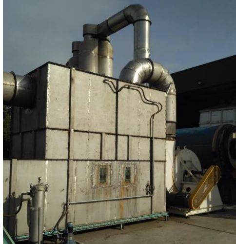
Figura 5.12 - Estação de limpeza de gases
