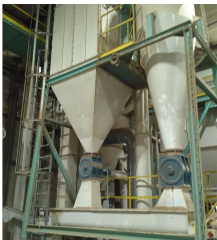
Figura 5.11 - Sistema de filtragem de ar (moinhos)
