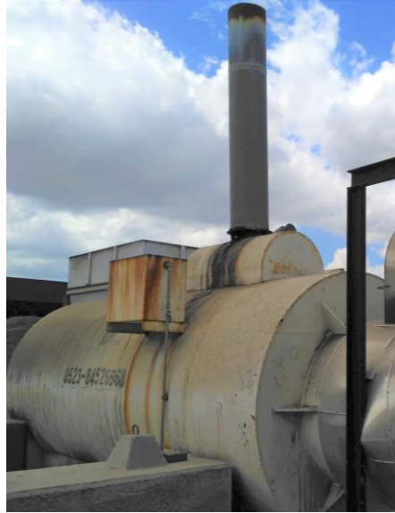
Figura 5.59 - Chaminé de escape
