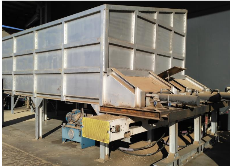
Figura 4.5 - Silo de estilha
