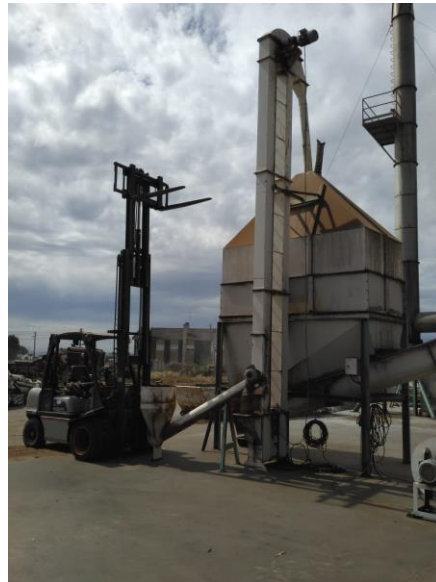
Figura 5.57 - Sistema de alimentação de pó de cortiça
