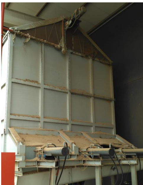
Figura 5.68 - Silo de serrim
