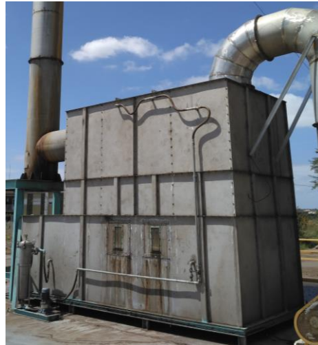
Figura 5.69 - Estação de limpeza de gases
