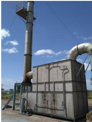
Figura 5.52 - Estação de lavagem de gases
