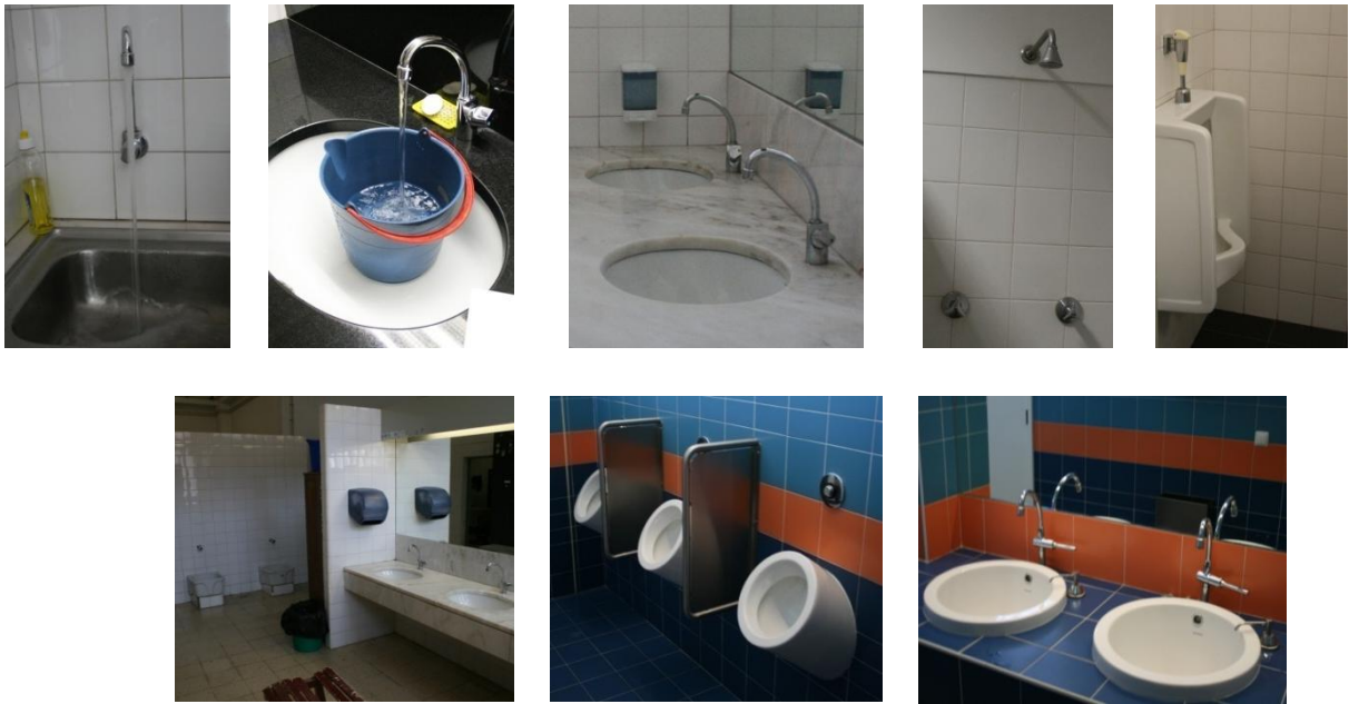
Figura 4.20 – Dispositivos de utilização da água nas instalações sanitárias, balneários e copa do edifício DHA
