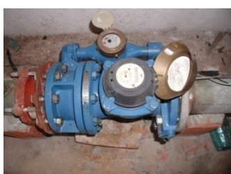
Contador 3 – Edifício Calouste Gulbenkian
