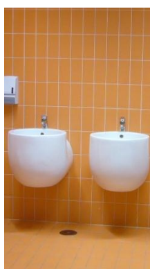
a) Torneiras no refeitório
