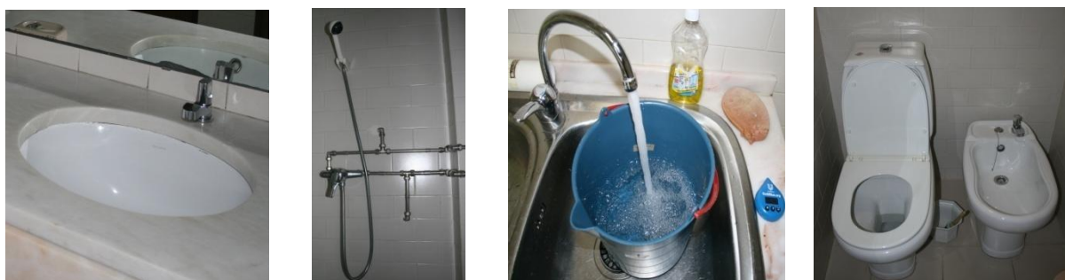
Figura 4.18 – Dispositivos de utilização da água nas instalações sanitárias e copa no edifício do NES
