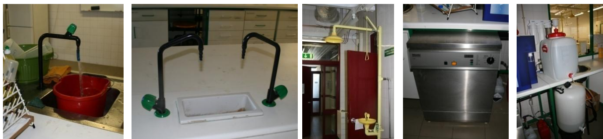
Figura 4.9 – Dispositivos e equipamentos de uso da água existentes no laboratório do edifício Departamental
