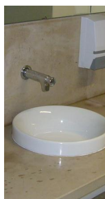
c) Torneira nas instalações sanitárias
