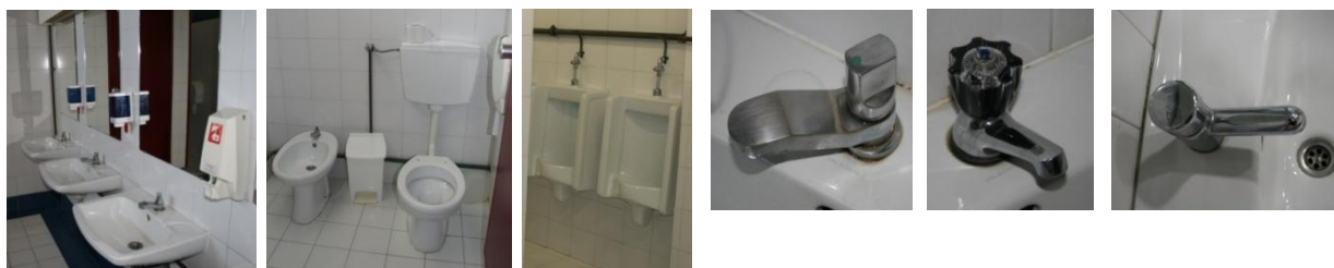
Figura 4.8 – Dispositivos e equipamentos de uso da água existentes nas instalações sanitárias do edifício Departamental
