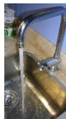
d) Torneira na sala de aula
