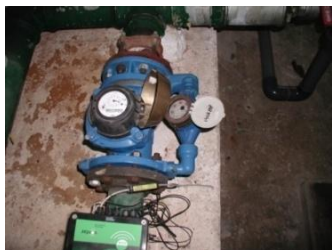
Contador 2 – Edifício principal
