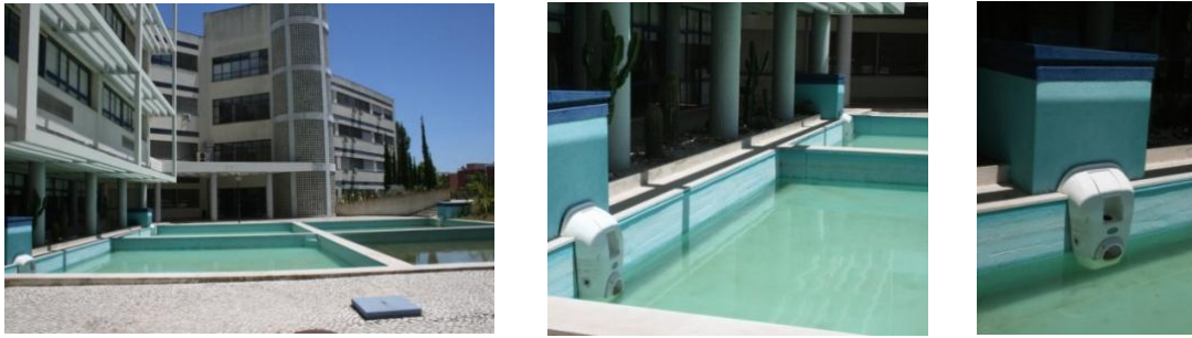
Figura 4.6 – Reservatórios do Serviço de Incêndios nas traseiras do edifício Departamental
