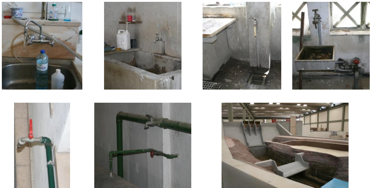
Figura 4.21 – Dispositivos de utilização da água nas salas de trabalho do edifício DHA
