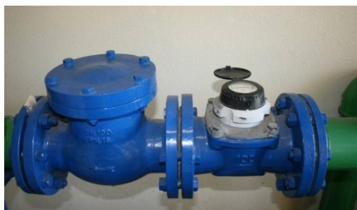
Figura 4.5 – Contador Bruno Janz existente na entrada do edifício Departamental
