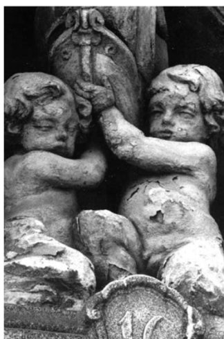
Figura 2.23 - Degradação por reação química [75]
