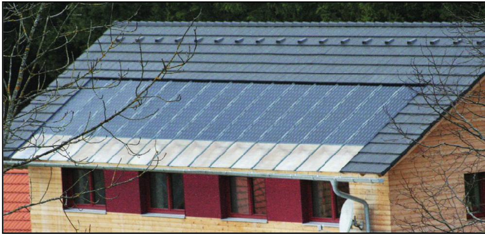
Figura 2.25. Sistema fotovoltaico em cobertura inclinada, Thyrnau/Áustria (Fonte: http://ertex-solar.at )
