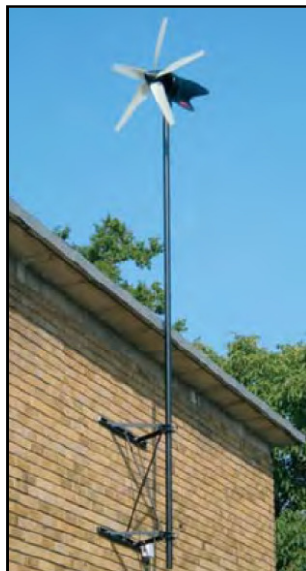
Figura 2.28. Exemplo de uma micro-turbina eólica, em posição vertical, fixada à parede de um edifício em Camberwell/Londres (Fonte: English Heritage, 2008)
