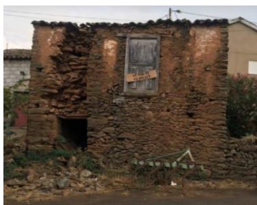
Figura 2.1 - Edifício em ruínas por falta de intervenção
