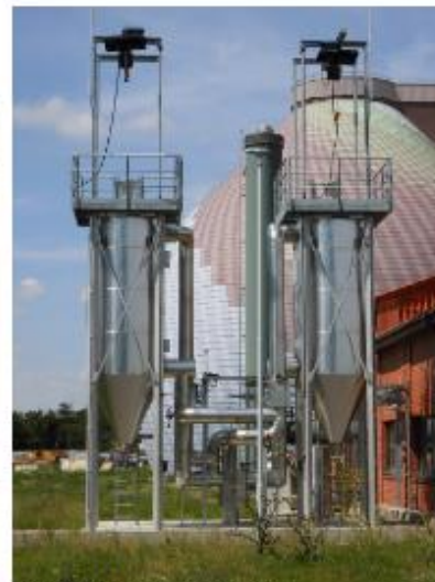
Kläranlage Magdeburg-Gerwisch 2 x 7 m 3 / Außenaufstellung isoliert Abscheidung von Siloxanen und H 2 S
